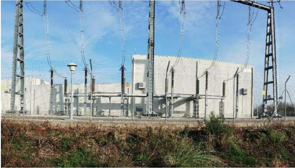
Fotografía 7. Subestación eléctrica (SE) Cicero
